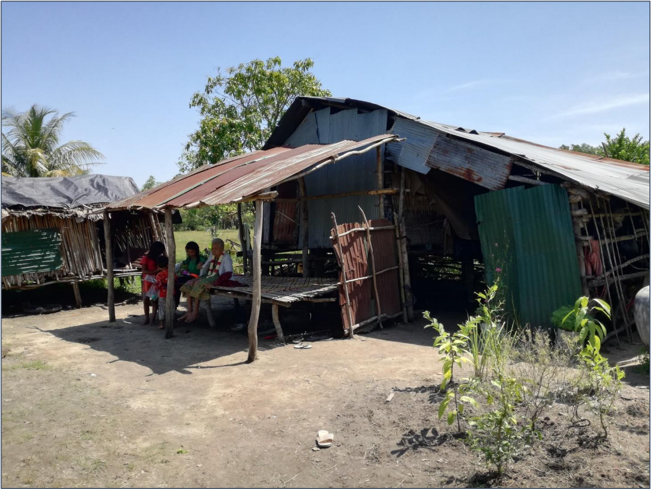
Een heel oud huis waar een heel gezin woont. Het huis is flink aangetast door termieten en staat bijna op instorten. Er wordt gevraagd om een nieuw huis.
